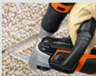
U nebezpečných spárovacích materiálů (např. PCB) se používá odsávání prachu.
